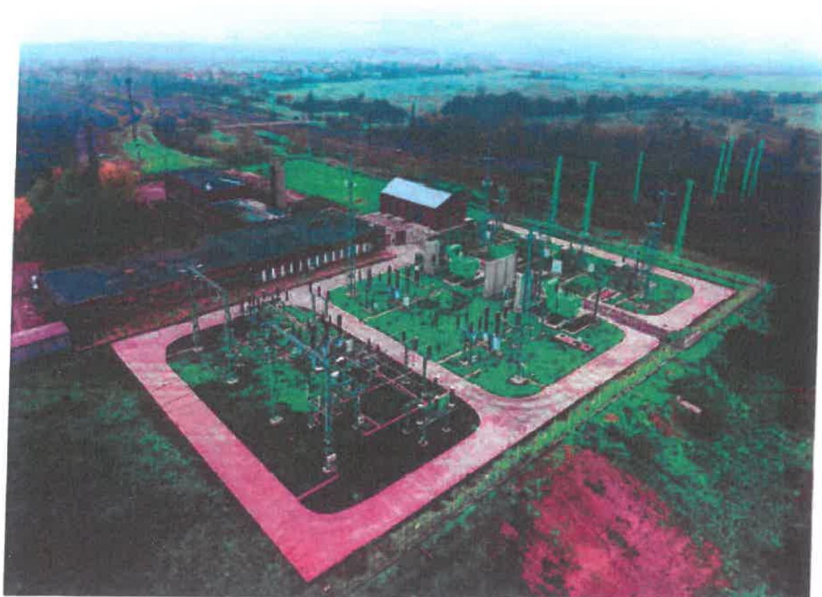
4. ábra 110/220/10/20 kV állomás Szombaton (Forrás: Magyar Építőipar)
