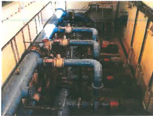
5. kép: Hálózati szivattyú gépház
