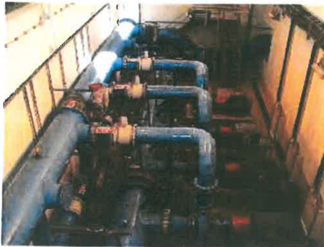
5. kép: Hálózati szivattyú gépház
