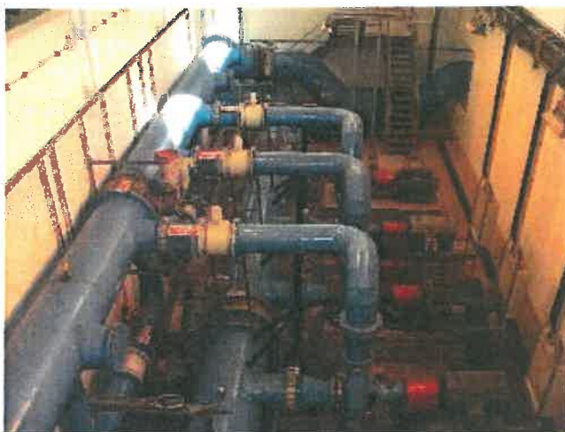
5. kép: Hálózati szivattyú gépház
