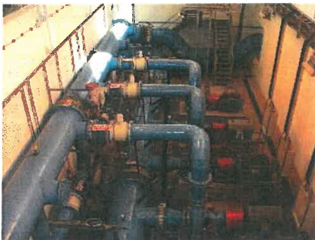
5. kép: Hálózati szivattyú gépház
